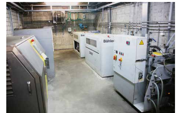
Fünf mächtige Höchstdruck-Pumpen versorgen über eine gemeinsame Zuleitung gleich 18 Wasserstrahlschneidmaschinen © Klaus Vollrath
