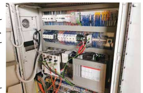
Blick ins Innere des von W. Althaus hergestellten Schaltschranks © Klaus Vollrath) © Klaus Vollrath
